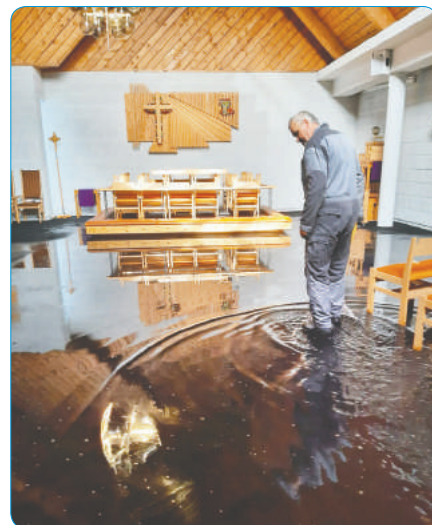
Rune Roset ser på resultatet av vasskaden som skjedde i påska
